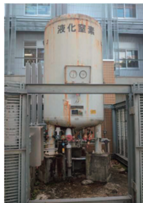
3号館北側の液体窒素設備 (2024年10月撮影)
